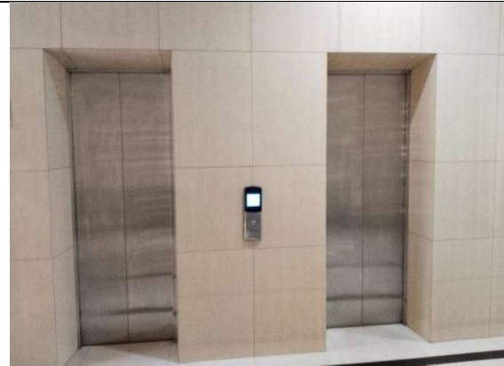
Gambar 6 Lift untuk jalur difabel di Gedung Kuliah
